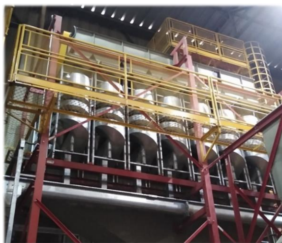
Figura 3. Conjunto de separadores em espiral. Dom Pedrito, RS, 2021.
