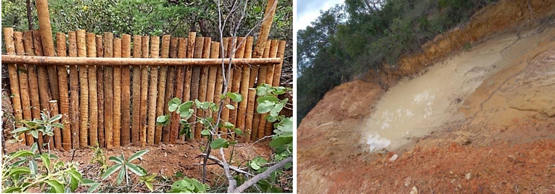
Figura 3. Paliçada e caixa de contenção (barraginha) construídas dentro do PECGerais durante a execução do Projeto SENDAS. Fonte: Os Autores.
