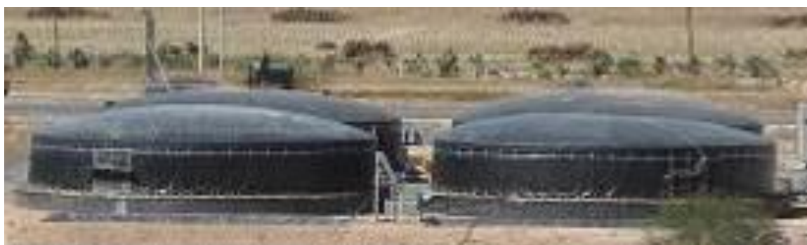
Figura 6. Serie de biodigestores adecuados para la generación de biogás a partir de biomasa de nopal.
