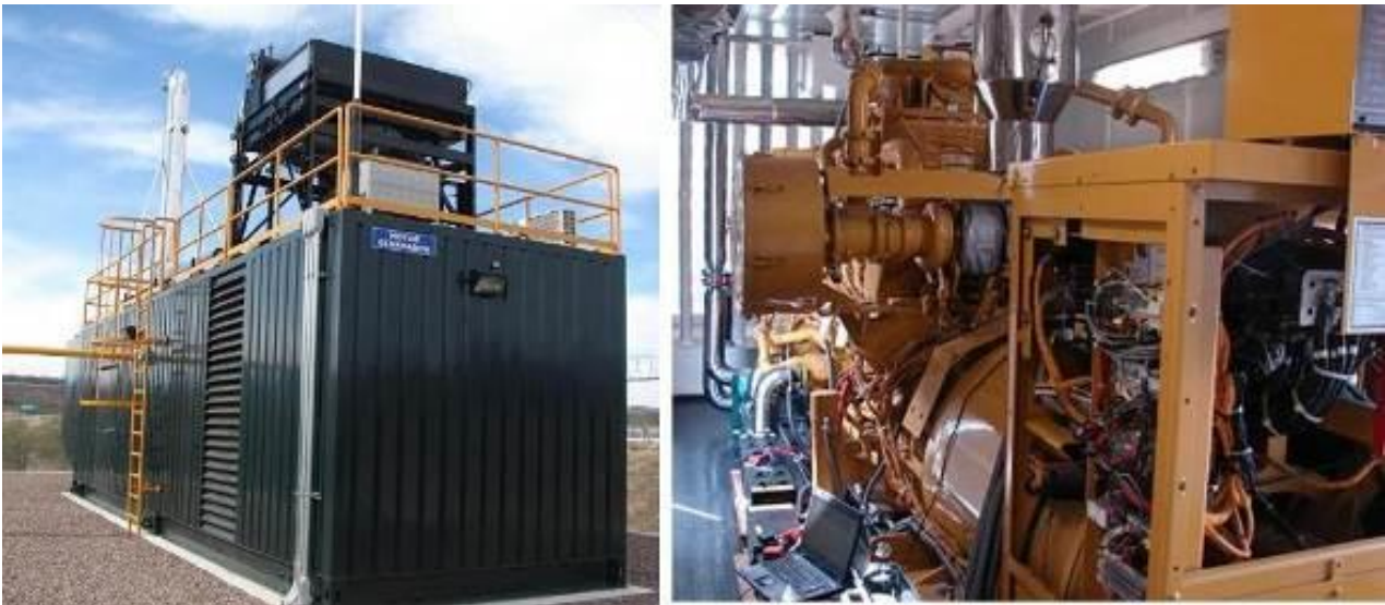
Figura 10. Motor generador de 1Mwh operado con biogás de biomasa de nopal.
