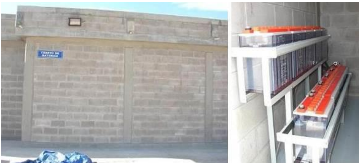
Figura 12. Vista externa del cuarto de baterías y el interior con las baterías en serie.
