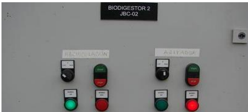
Figura 7. Tablero de control de biodigestores de flujo continuo para la generación de biogás a partir de biomasa de nopal.
