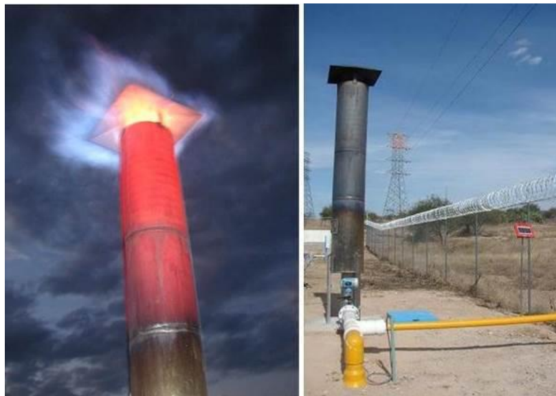
Figura 13. Ilustración de mechero utilizado para la quema de excedentes de biogás.
