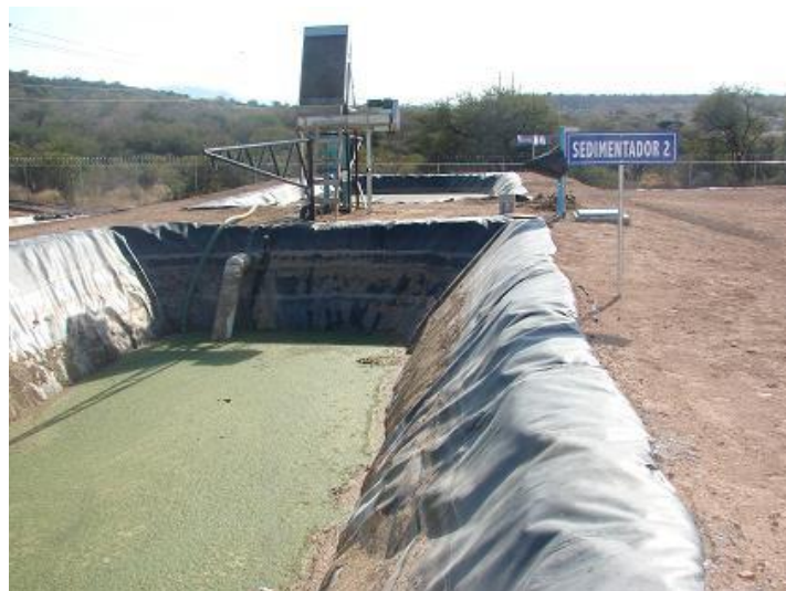
Figura 15. Sedimentador 2 y separador de fibras finas para residuos del sistema de biodigestión mesofílica de biomasa de nopal.
