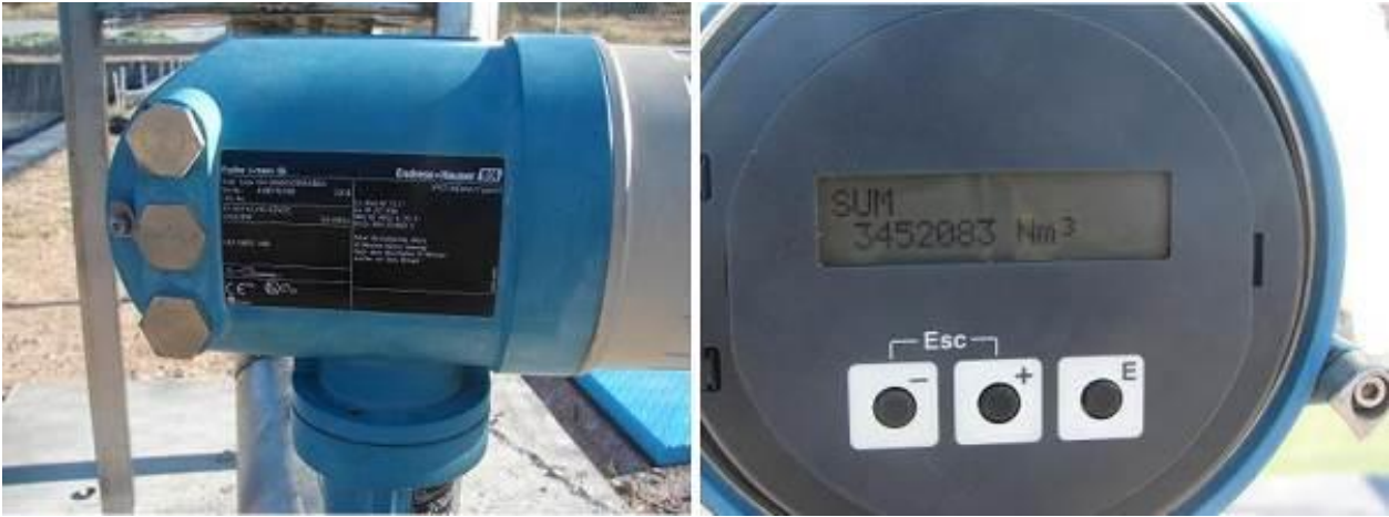
Figura 8. Medidor de flujo de biogás operado mediante sensor.
